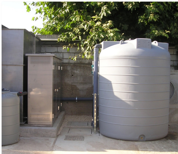
Impianto di depurazione chimico-fisico delle acque reflue
